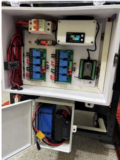
รูปที่ 3.38 การเก็บสายไฟ
