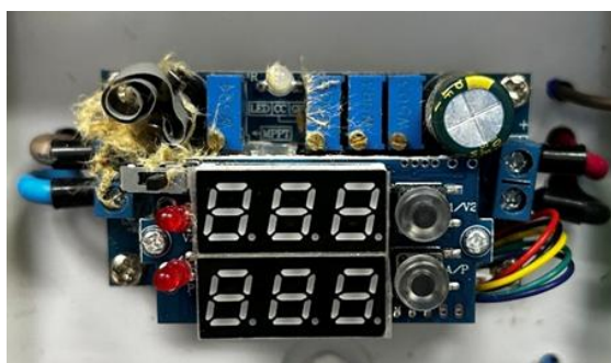
ภาพที่ 5-37 DC MPPT Controller 5A DC-DC Step Down ที่เกิดการระเบิด
