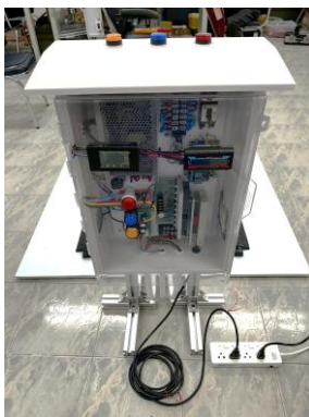
ภาพที่ ฉ-1 เสียบปลั๊กไฟฟ้ากระแสสลับ 220V เข้าสู่ตู้ควบคุม
