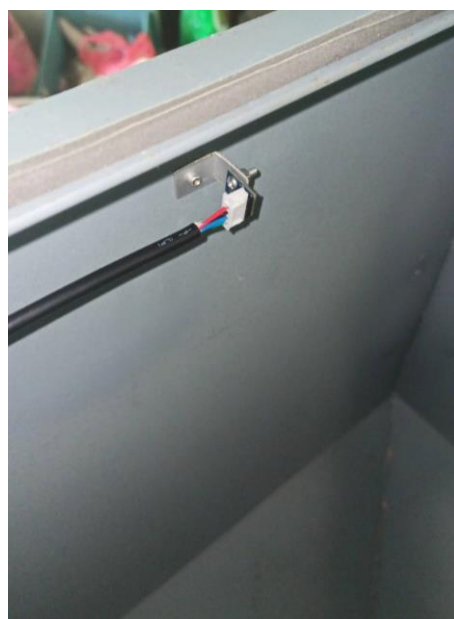
รูปที่ 3.12 เซ็นเซอร์ AHT30 ควบคุมอุณหภูมิของฮีตเตอร์ที่ติดตั้งภายในตัวถังเก็บข้าวเปลือก
