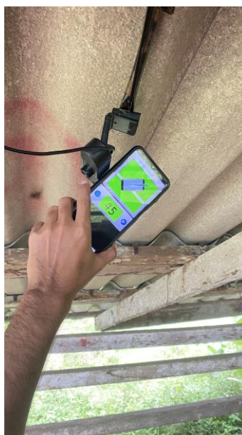
รูปที่ 3-12 องค์การติดตั้งกล้อง
