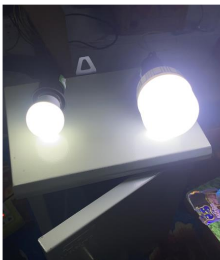
รูปที่ 4-2 ทดสอบการเปิดและปิดรีเลย์โดยใช้หลอดไฟ
