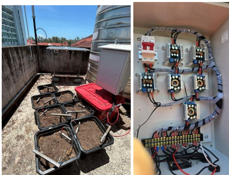
ภาพที่ 3-1 ตู้ควบคุมแรงดันและกระแส
