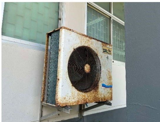
ภาพที่ 1-1 โครงคอยล์ร้อนแอร์ที่อาคาร 58 อาคารศูนย์วิทยบริการ มทร.สงขลา
