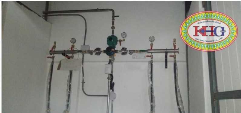
รูปที่4: ระบบแก๊สร้านสะดวกซัก
