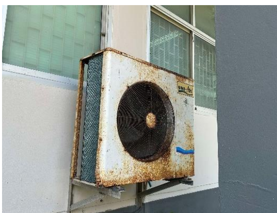
ภาพที่ 1 เครื่องคอยล์ร้อนแอร์ที่อาคาร 58 อาคารศูนย์วิทยะบริการ มทร.สงขลา
